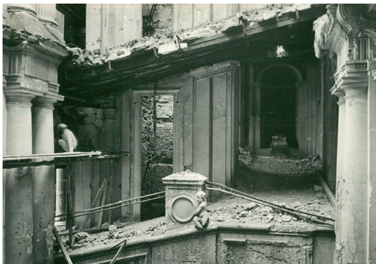
Teilansicht des ausgebrannten, aber wiederaufbaufähigen Treppenhauses
