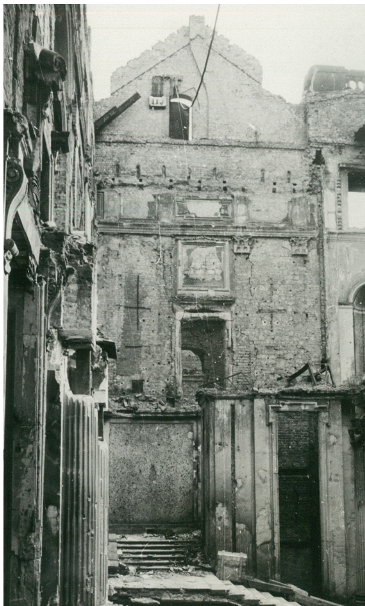
Die Zwischendecken im Bereich des Schweizeraals, zu dem die Treppe führte, sind bei dem Schlossbrand eingestürzt, sie wurden von Holzbalken getragen.
